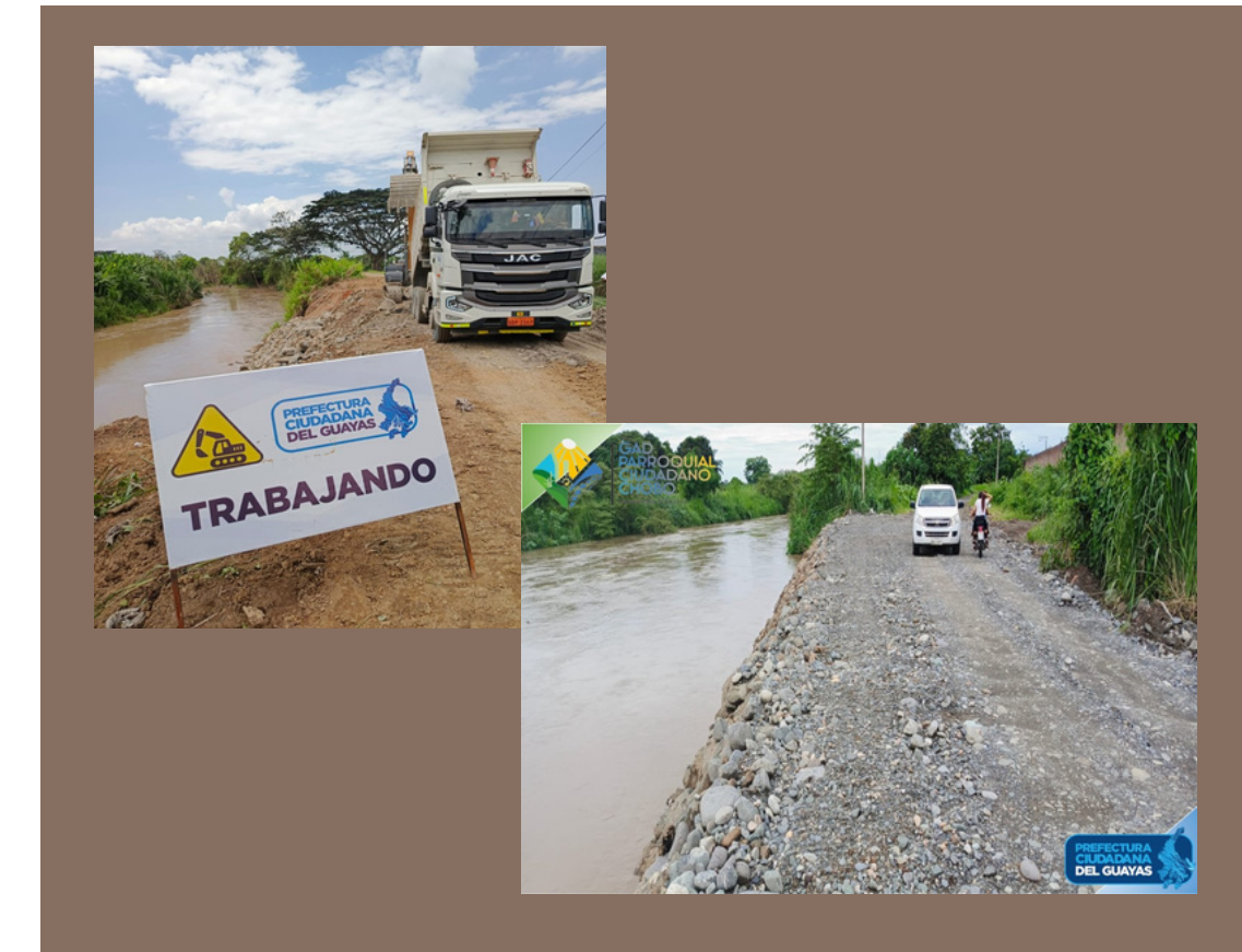
Gestión realizada con la Prefectura del Guayas en la limpieza de esteró Belin, Limpieza Rio Milagro, 1km limpieza Estero los Monos, reconfiguración de muros de contención Rio Chimbo reforzando con piedra escollera, por deslizamiento de tierra del muro contención.
